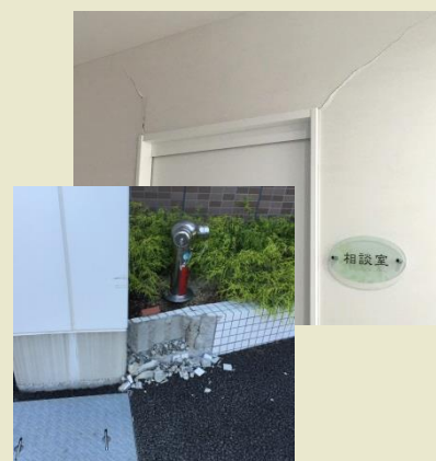
あちこちにひび割れやひずみがあった。
